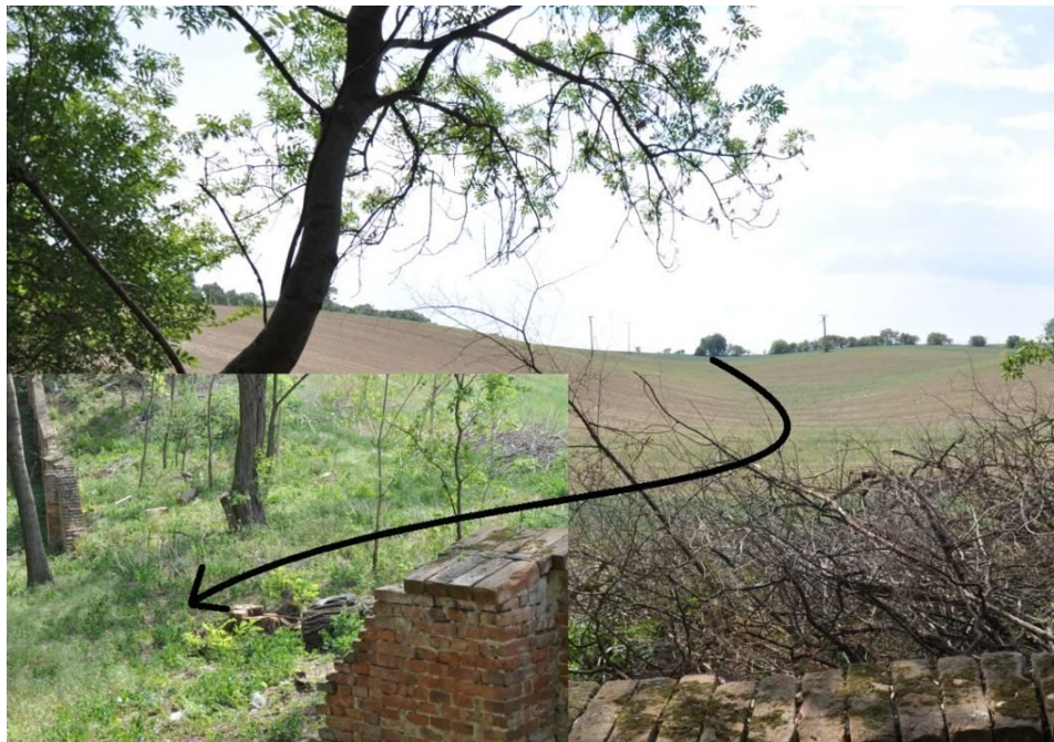
Obr. 4 Narušená zeď zámecké zahrady ve Valticích vlivem přívalové srážky
